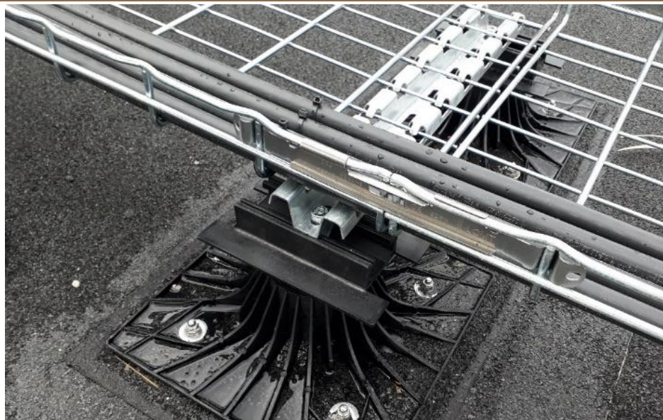
Figure 14 : Plot SOPRASOLAR FIX EVO utilisé comme support de chemin de câbles
